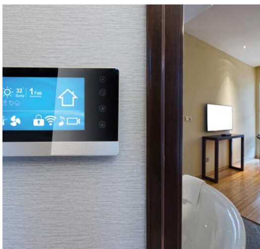
Rys. 2. Nowoczesne systemy sterowania budynku pozwalają na zarządzanie akumulacją ciepła
